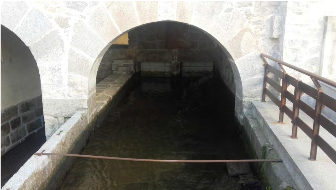
Tramo inicial del canal de Sabatini. Compuertas de entrada
