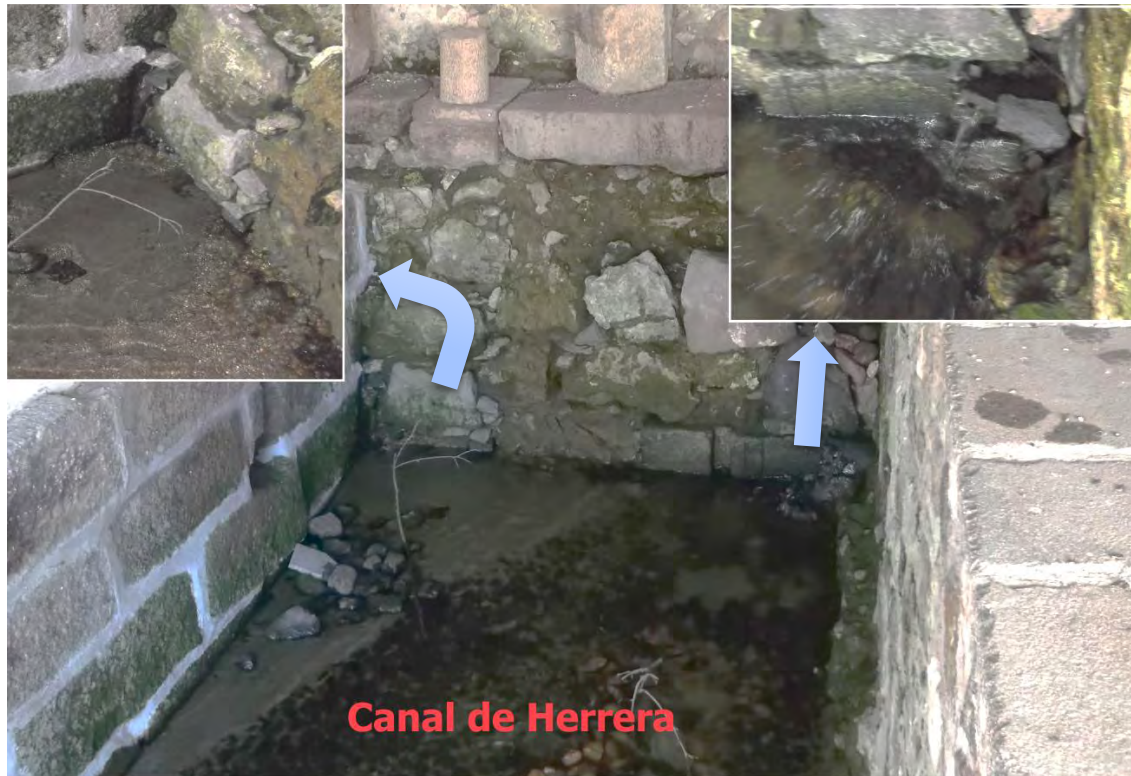
Figura 1.3.11. Filtraciones de agua por la base del canal de Herrera.
