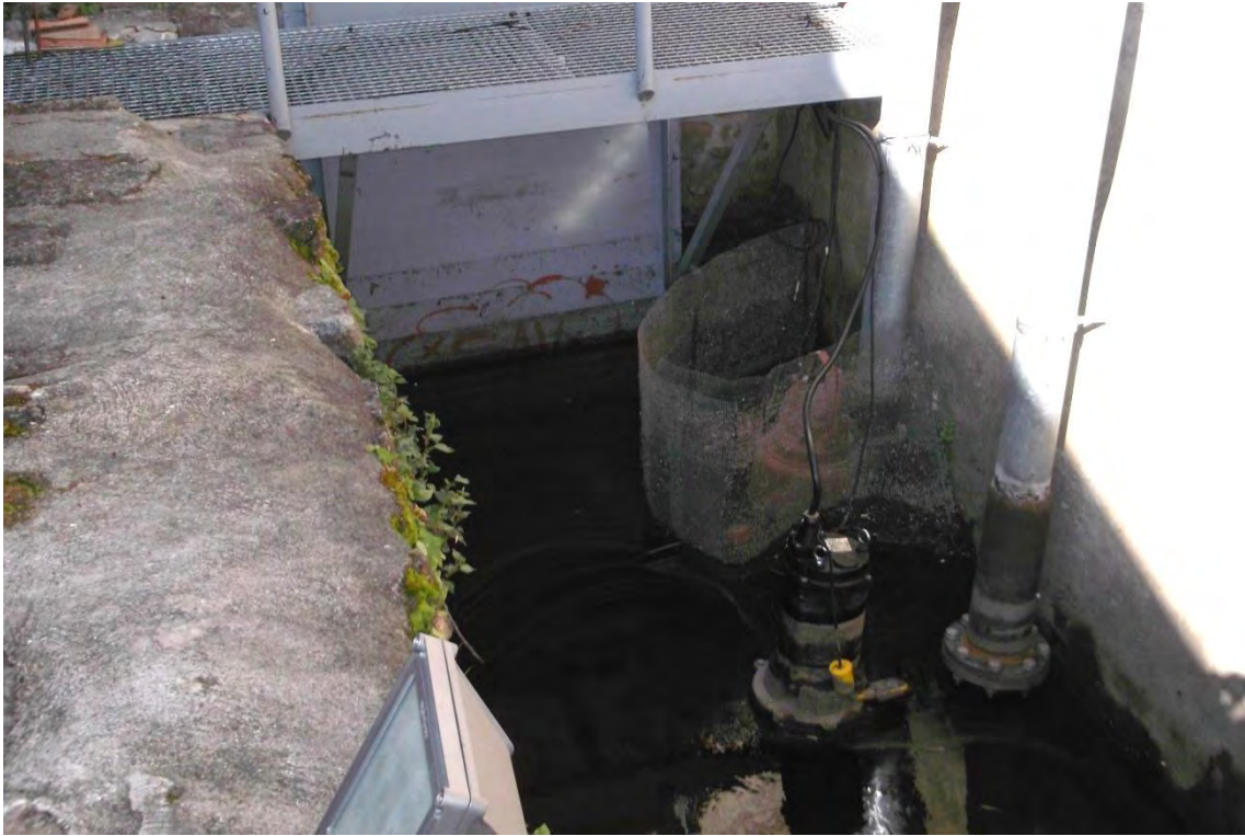
Ubicación de las bombas achique. Compuertas de salida
