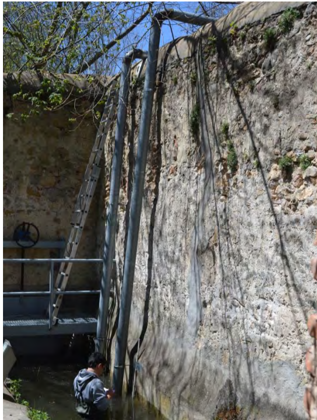
Tubería de evacuación de agua procedente del bombeo
